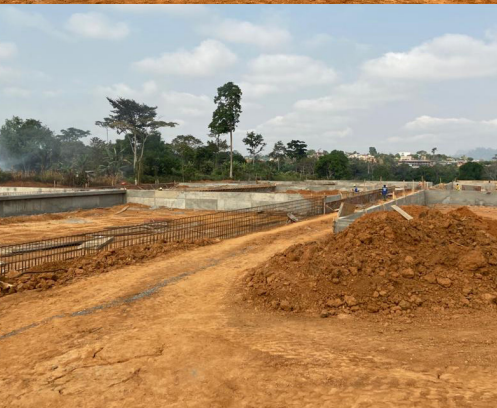
Terrassement pour la construction de la station de traitement des boues de vidange.
