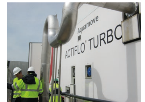
Couplage décantation physico-chimique - charbon actif (Veolia)
