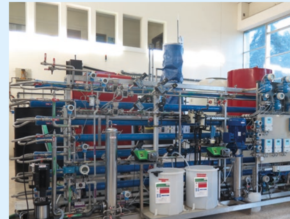
Pilote nanofiltration - Ville de Lausanne
