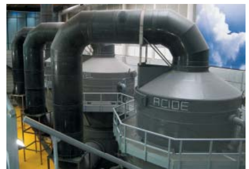
b. Tours de désodorisation chimique (Seine aval)
