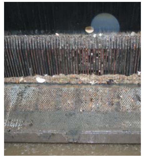
b. Dégrilleur (Seine aval)
