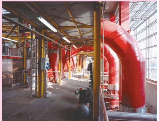
b. Four à lit de sable fluidisé (Seine centre)
