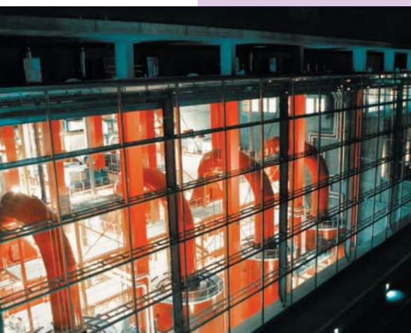
Figure 49 : Fours d'incinération des boues de nuit (Seine centre)
